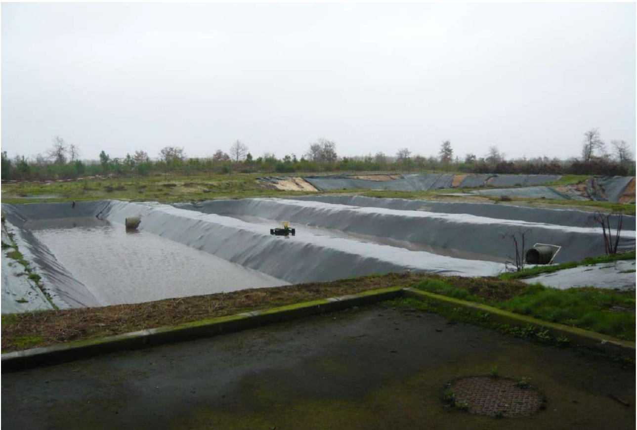
Figure 50 : Lagunes de traitement en série de l'usine de compostage de Thalie
